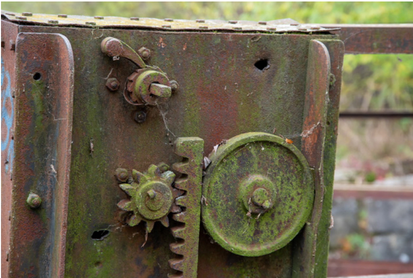
Fragment starego mechanizmu do obsługiwanego śluzy na Międzyodrzu. Fot. Piotr Rosiński
